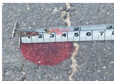
Figure 8. Longitudinal Crack Damage on STA 3+450 - STA 3+550
